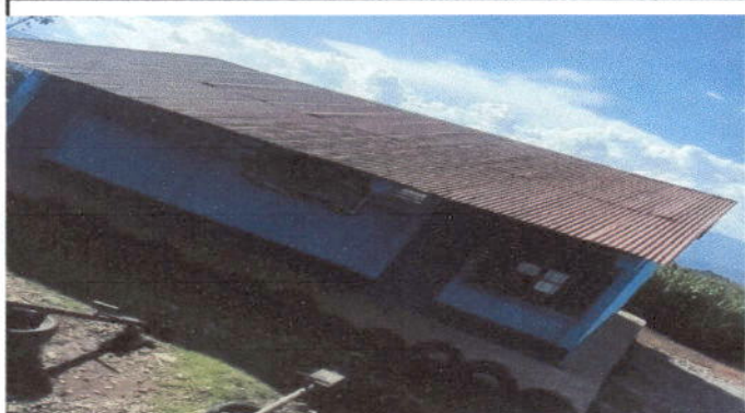
Foto 7: Cambio de techo por deterioro Módulo 1
