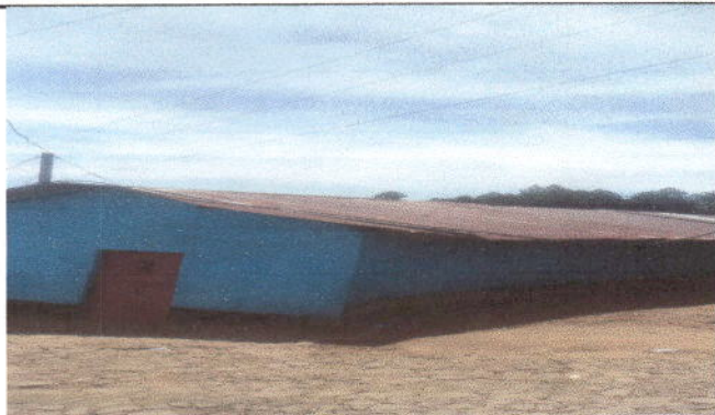
Foto1: Cambio de techo por deterioro módulo 2
