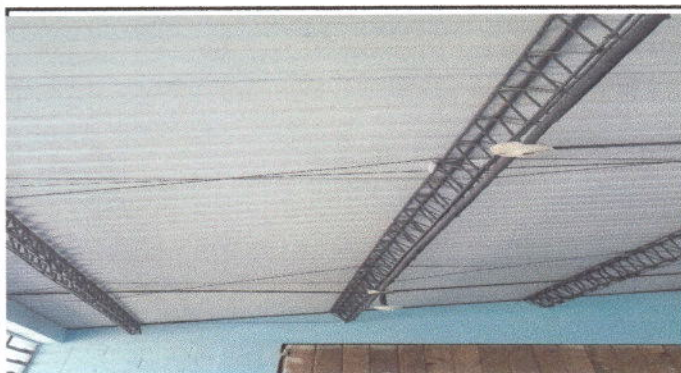
Foto 3: Focos en el aula en todas las aulas
